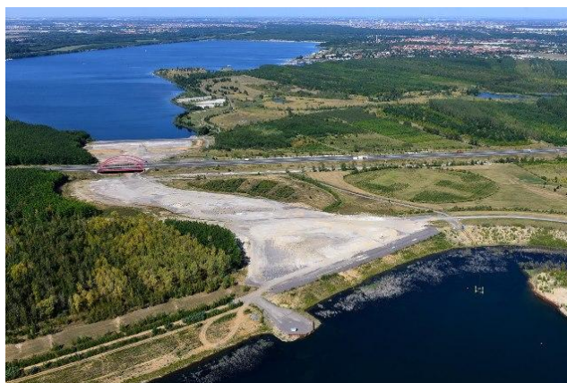
Bild 3: 2016 Weiterführung der Baugrundvergütung im Trassenbereich des künftigen Harthkanals zwischen Cospudener (oben) und Zwenkauer See (unten) durch Schüttung von Auflastkörpern. Quelle LMBV-Presseveröffentlichung vom 13.10. 2016
